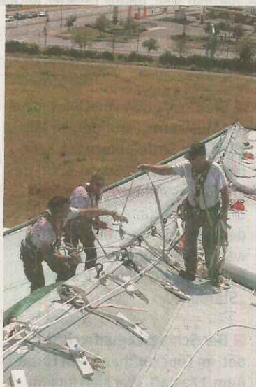
Arbeiten in 32 Metern Höhe: Die Firma „Ceno Tec“ werkelt schon auf Schalke.
